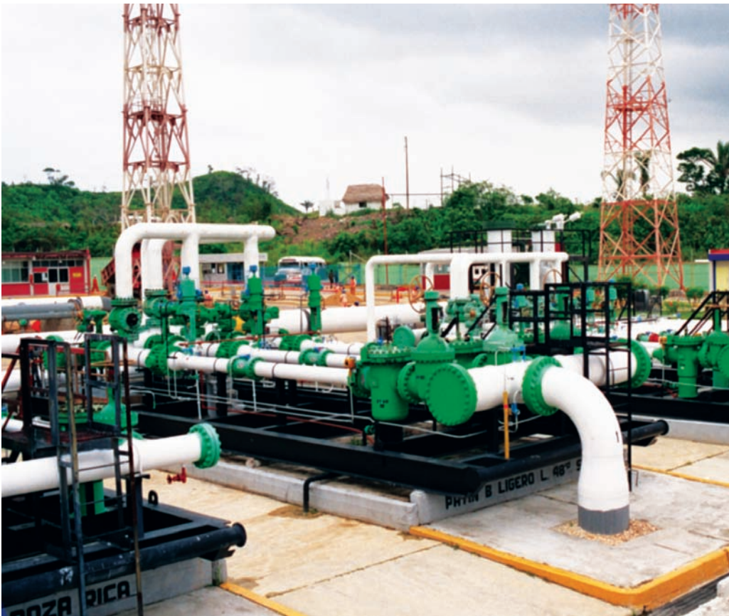
Estación de bombeo Ubicada en Nuevo Teapa, Minatitlán
