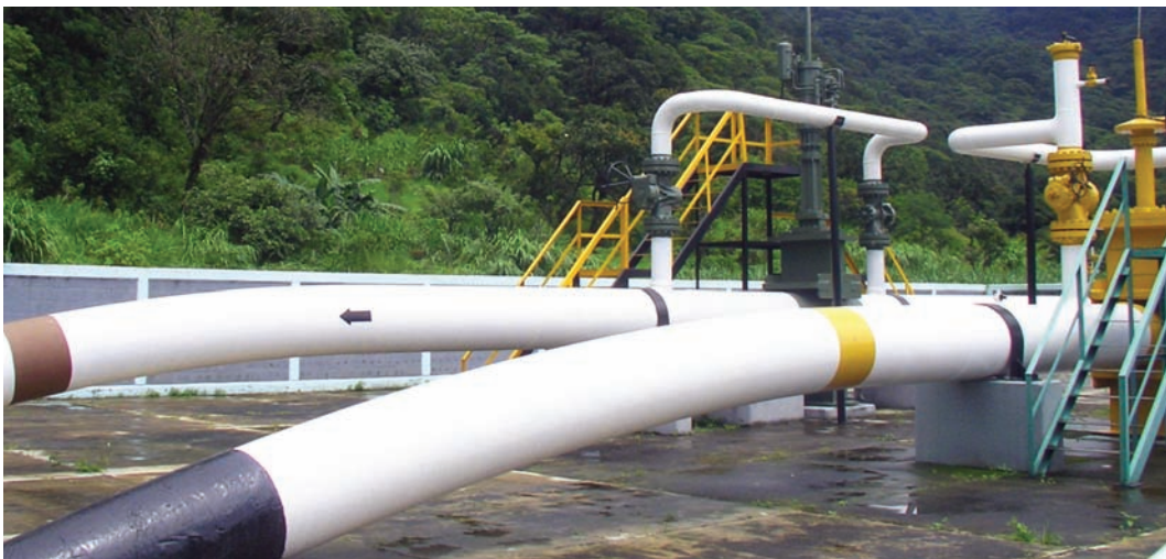
Sistema de transporte de Gas ubicado en Nogales, Veracruz
