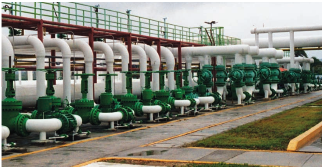
Estación de Hidrocarburos Las Palomas ubicada en Coatzacoalcos, Veracruz
