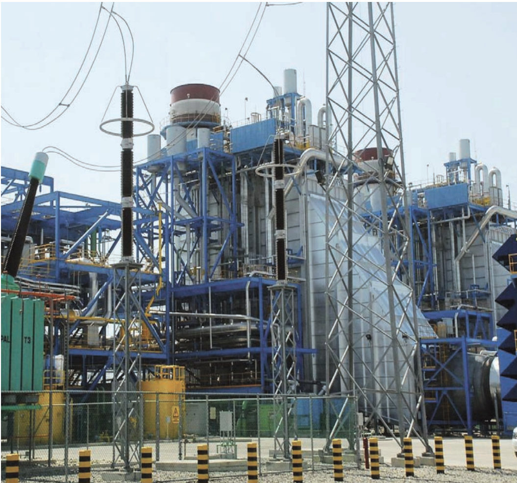
Termoeléctrica Adolfo López Mateos ubicada en Tuxpan, Veracruz
